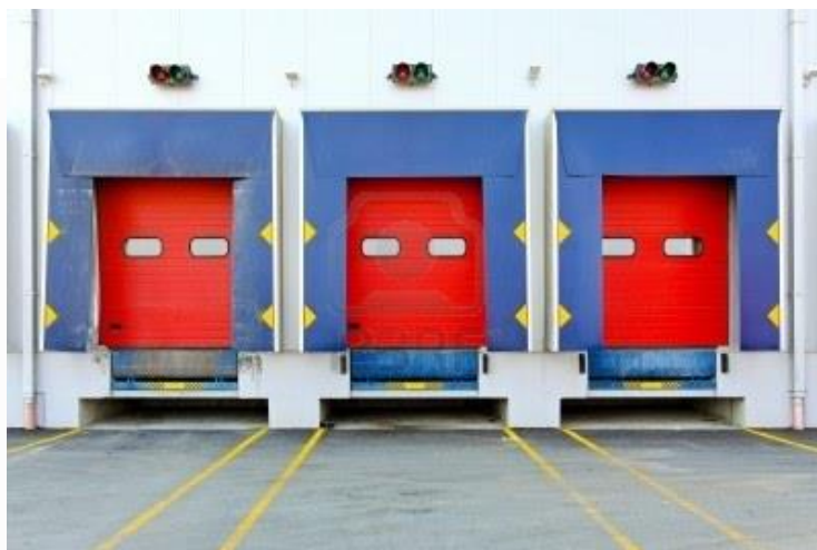
Figura 8. Puerta de muelle
