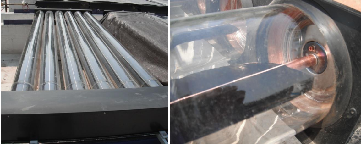
a) Captador solar de tubos evacuados: a) instalación y b) tubo evacuado vidrio-metal.
