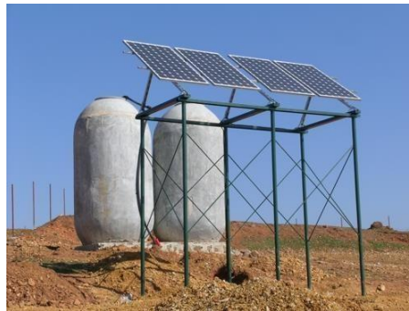
Sistema de bombeo fotovoltaico. Fuente: tomado de http://www.eraingenieria.com/portal/lang_es-ES/tabid_7113/default.aspx
